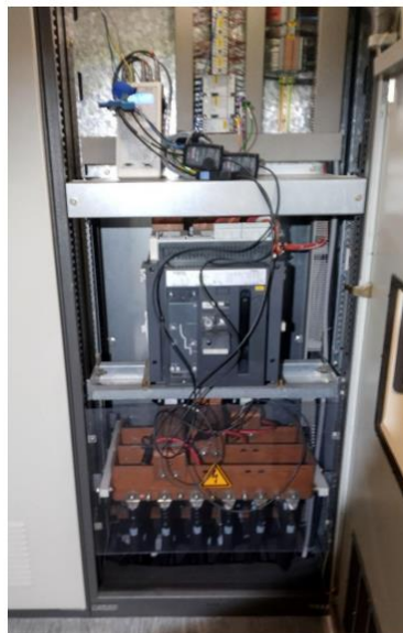
Abbildung 7.1: Einbausituation der Messtechnik des Feldtests beim Wupperverband
